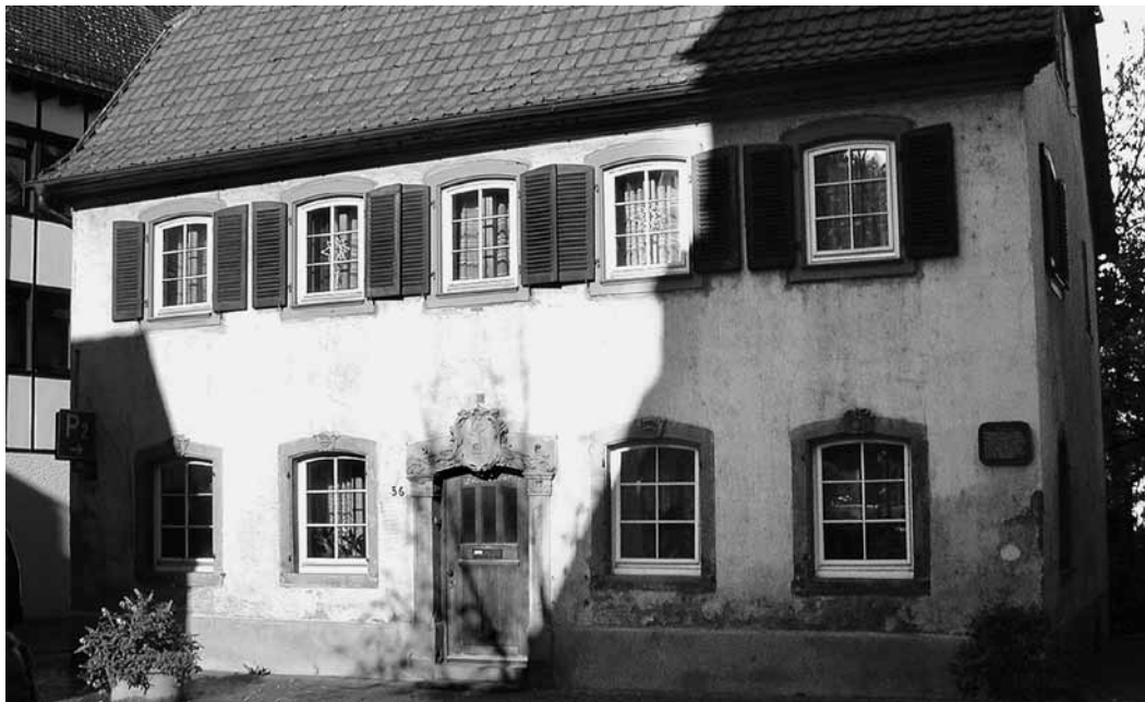
Licht und Schatten, lag über dem denkmalgeschützten Gebäude der Kaplanei, das sich in einem desolaten baulichen Zustand befindet. Durch den Kauf der Stadt, hofft man nun in der Bevölkerung, dass nun das Licht die Oberhand bekommt und das Gebäude renoviert wird.
